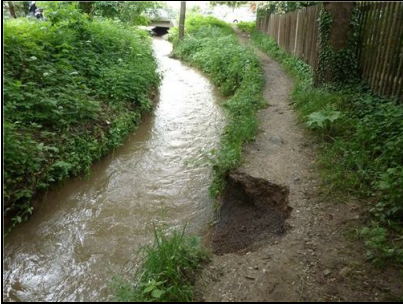
Abb. 33: Uferabbruch im Bereich eines Weges beim Hochwasserereignis im Juni 2013; 10.06.2013
