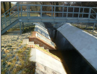
Abb. 22: Pegel Kauscha UP der Landestalsperrenverwaltung Sachsen an der Talsperre Kauscha, Blick stromab; 02.03.2011
