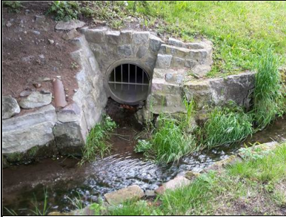
Abb. 31: Regenwasser-Einleitstelle 39E14 in den Geberbach; 06.05.2019
