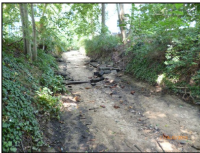
Abb. 35: Sohlverbau der Prießnitz unter abgelagertem Sand zwischen Bischofsweg und Hohensteiner Straße bei Trockenheit; 11.08.2015
