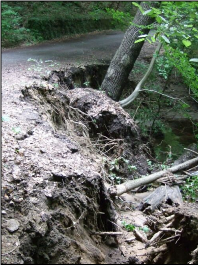
Abb. 44: Kolk am Uferweg nach dem Hochwasser im Juni 2013; 06.06.2013
