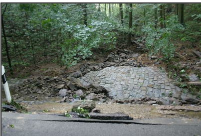
Abb. 34: Schäden am Helfenberger Bach, Höhe Einmündung Förtsterbach nach Hochwasserereignis; 06.07.2006
