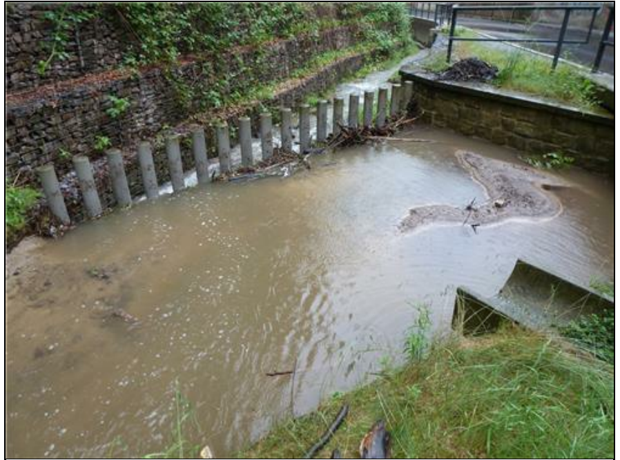
Abb. 26: Zugesehter Sedimentfang RFS018 und Treibgutfang RFT074 nördlich der Bebauung Helfenberger Grund 8 a bis i nach Regenereignis; 25.06.2013
