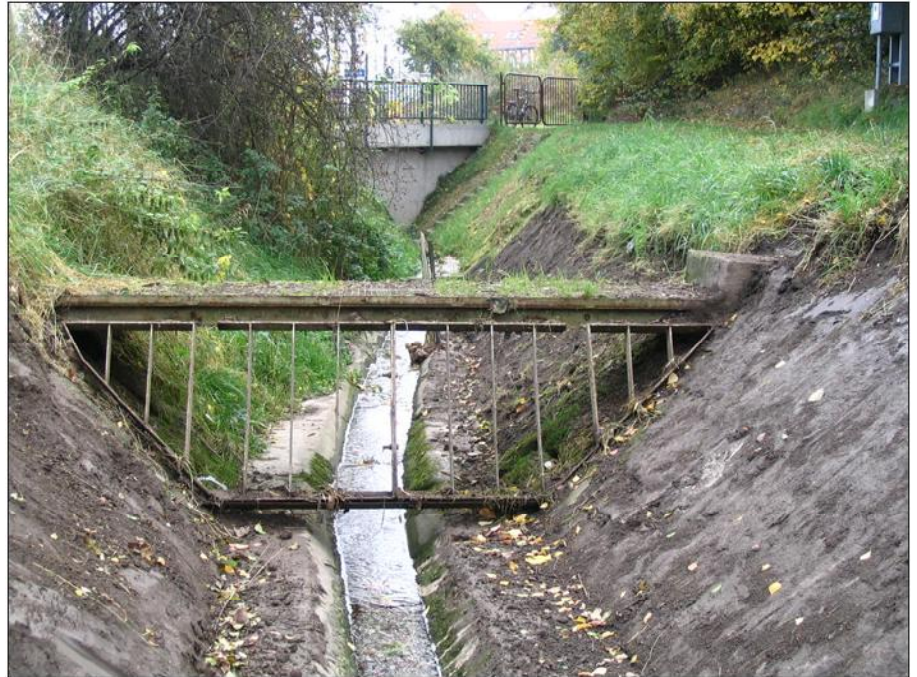
Abb. 18: Treibgutfang TF_LE_38 Gorbitzbach westlich Kesselsdorfer/ W.-Hippler-Straße
