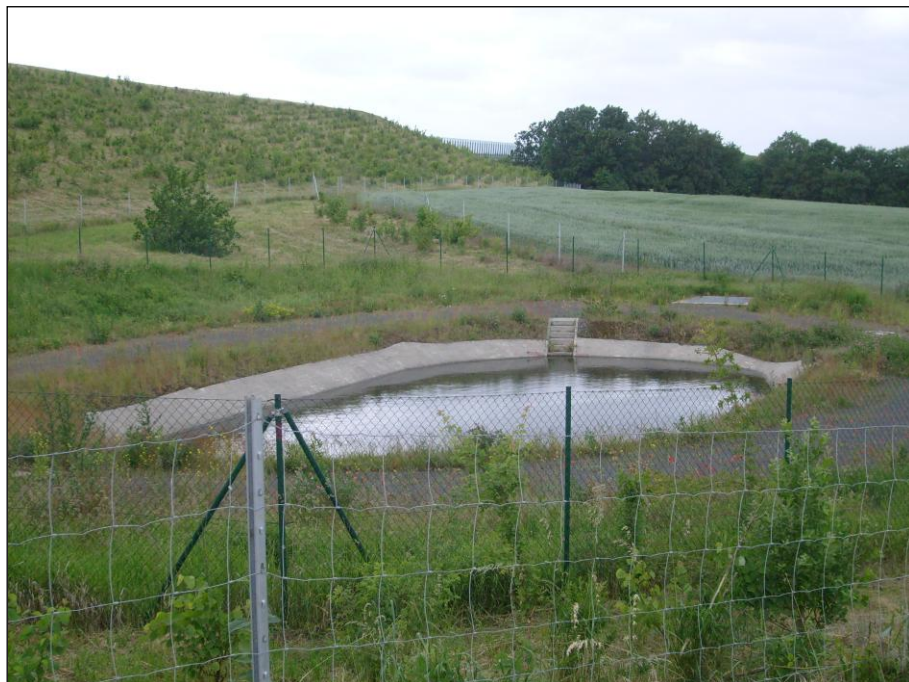
Abb. 18: Regenrückhaltebecken A17-RRB19 des Autobahnamtes mit Einleitung in die Talsperre Kauscha
