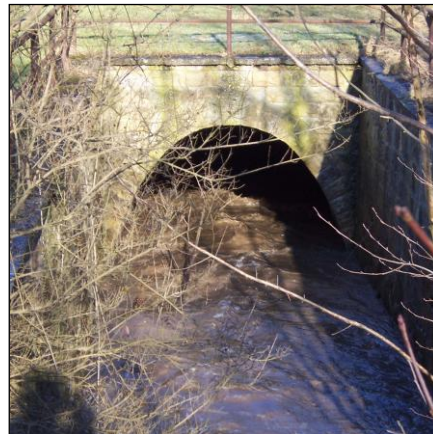
Abb. 30: (links) Einlauf in die Verrohrung Meißner Landstraße/ Pfaffengrund oberhalb Am Kirchberg bei erhöhter Wasserführung des Zschonerbaches am 17.02.2006
