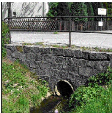
Abb. 13: Durchlass Straßenüberfahrt Kreuzung Zum Spitzberg/Marsdorf Hauptstraße
